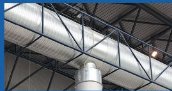
LIMPIEZA DE CONDUCTOS Higienización y calidad del aire
