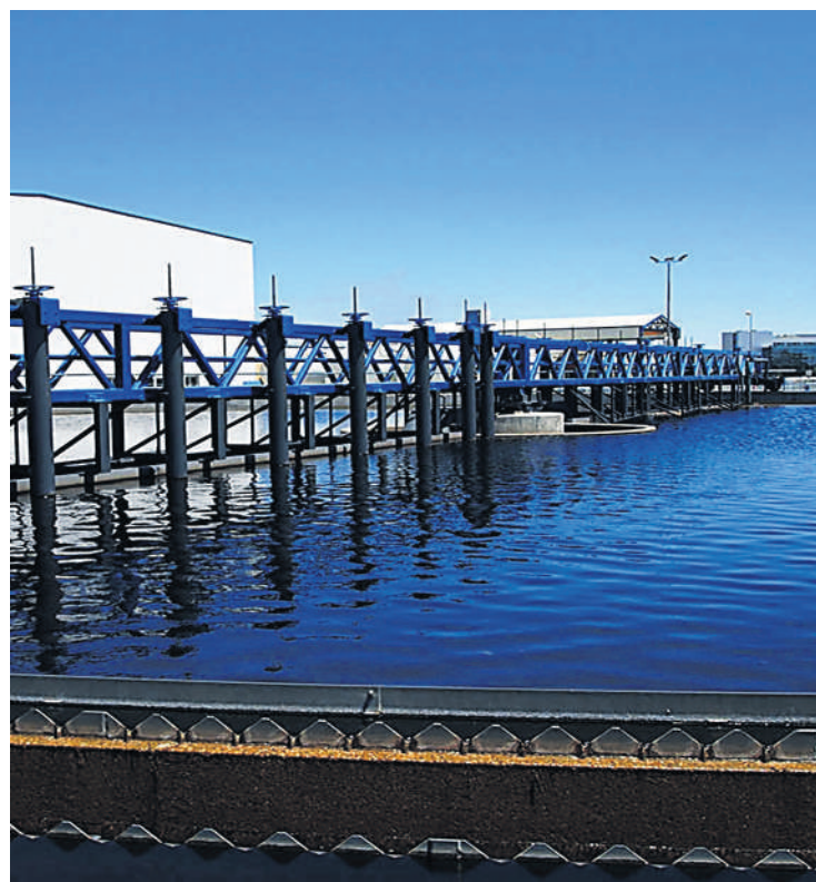
Estación Depuradora de Aguas Residuales Os Praceres, Pontevedra. Foto: Acciona
