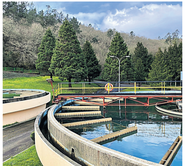
Estación de Tratamento da Auga Potable de Viaqua en Santiago. Foto: ECG
